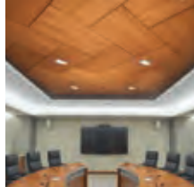
Cornisas de iluminación indirecta
