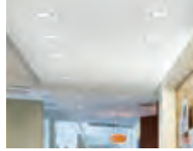
Luminaria embutida de intersección
