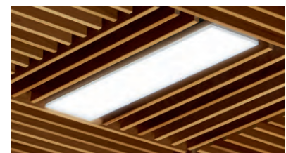
ILUMINACIÓN LINEAL: Placas verticales WoodWorks® Grille Tegular color Maple con luminaria lineal de 5-1/4" x 23-3/8".
